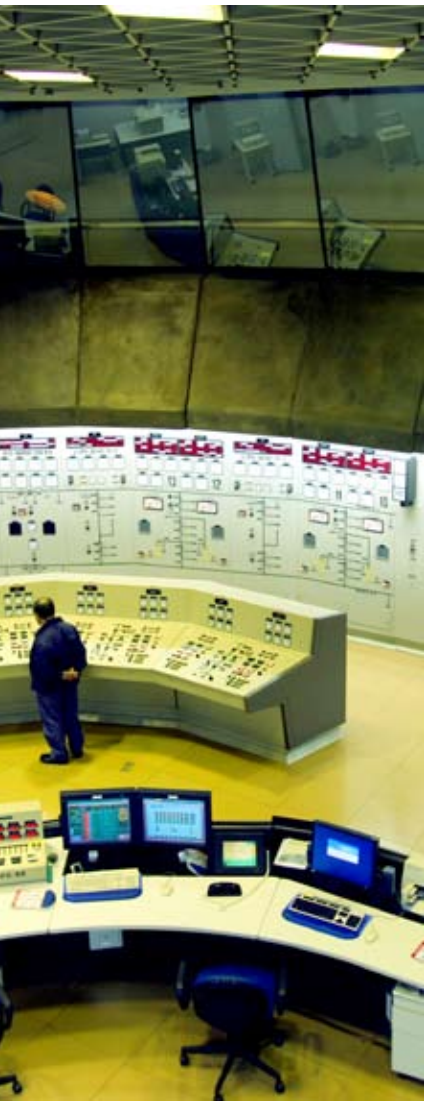
Itaipu – Sala de Controle (Foto: Caio Coronel)
