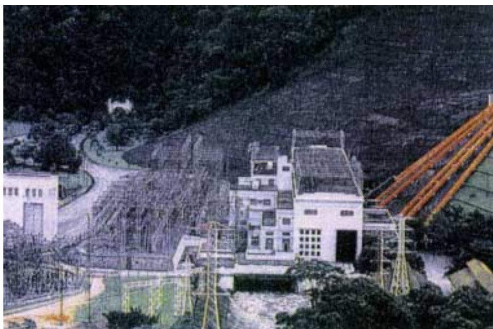
Figura 2 - UHE Henry Borden – 884 MW
