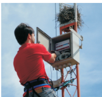
Detalhe da operação de coleta de informações por técnico da AEBA na torre em cujo topo encontra-se instalado um anemógrafo. Futuramente tal operação será efetuada “on-line”.
