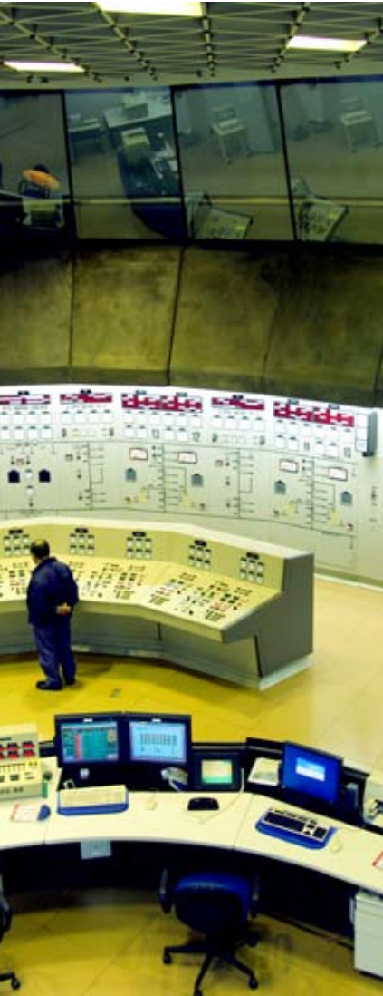
Itaipu – Sala de Controle (Foto: Caio Coronel)
