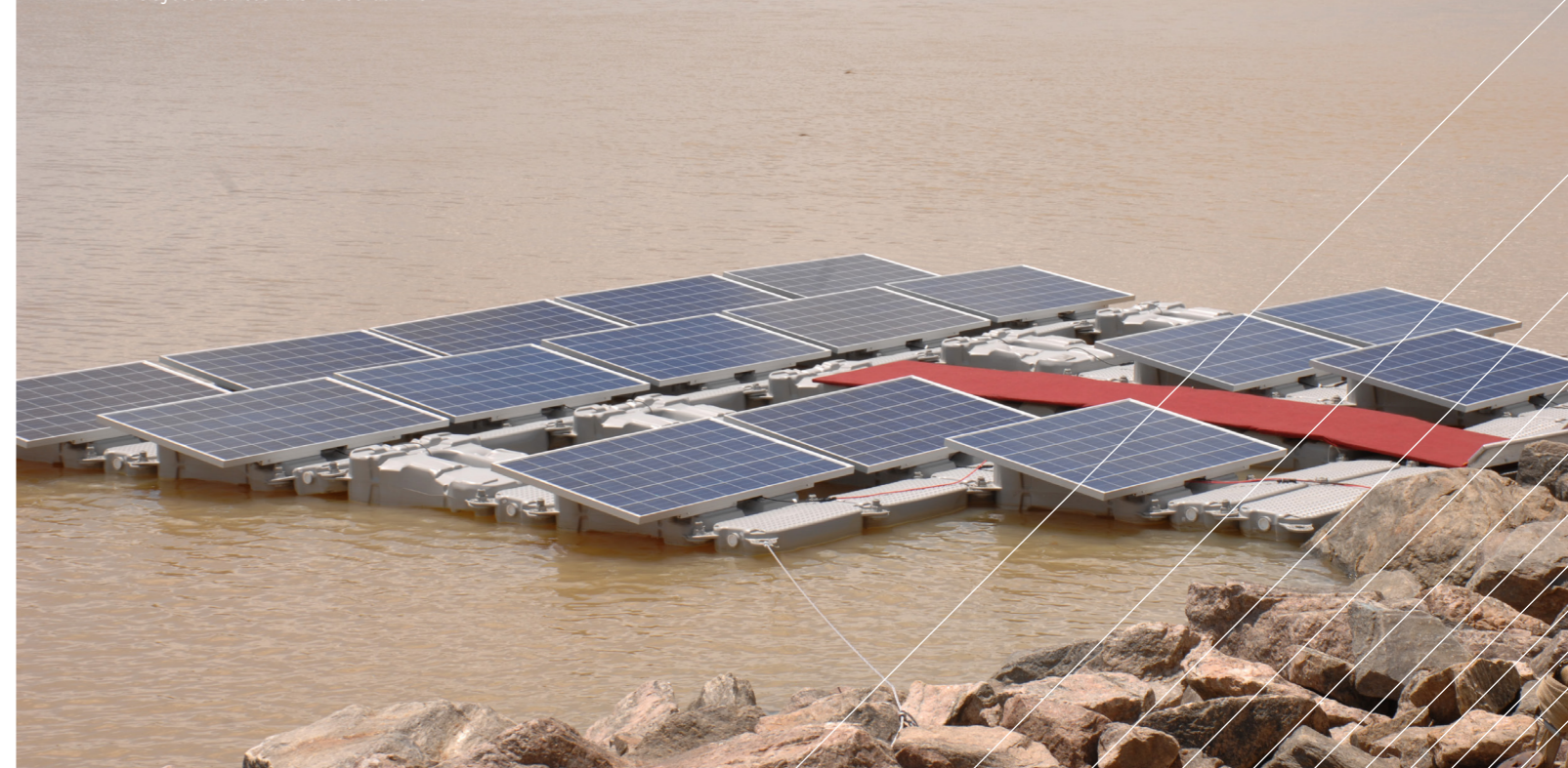
Painéis fotovoltaicos na UHE Sobradinho
